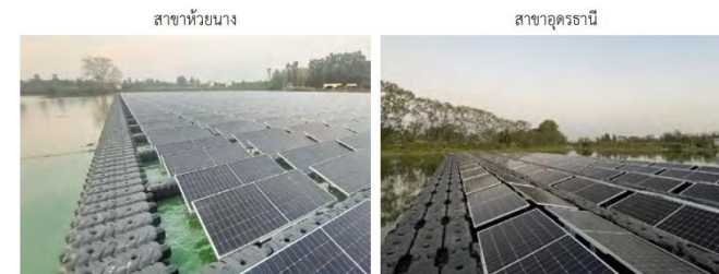
โครงการผลิตไฟฟ้าจากพลังงานแสงอาทิตย์บนทุ่นลอยน้ำ (Solar Floating Project) ณ โรงงานยางแท่ง
