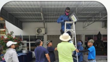
ปรับปรุงระบบไฟฟ้าและแสงสว่าง ศาลาสวดดอกิธรรมศพ (REF)
